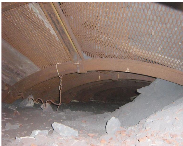
Рисунок 2.31 – недозаклад под сводом крепи, заходка №23
