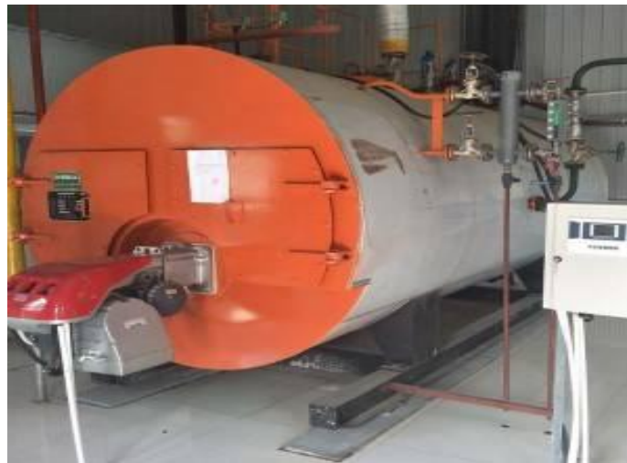
Рисунок 4.7 – Паровой котел турецкого изготовления
