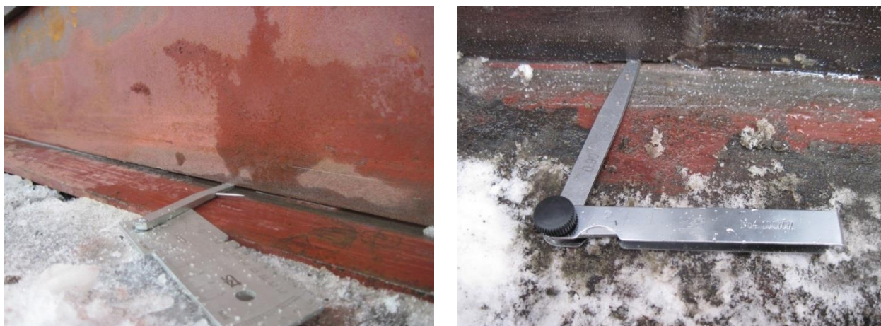
Рисунок 4 – Фото зазоров в уторном узле строящегося резервуара
