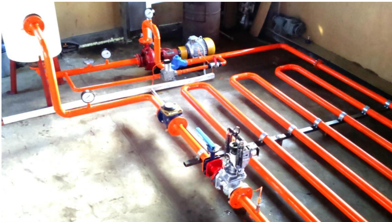
Рисунок 51 – Установка исследования гидроудара
