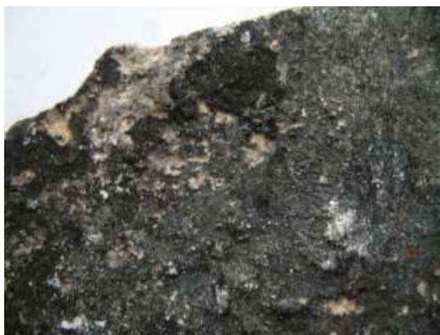
Рисунок 3.42 – Черная биопленка на поверхности штукатурного покрытия
