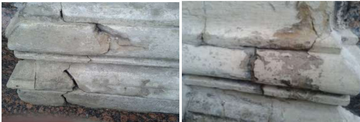
Рисунок 3.30 – Трещины в несущих конструкциях со стороны Миллионной улицы (фото автора, 2014 г.)
