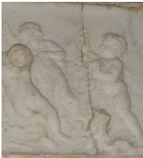
Рисунок 3.32 – Трещина в барельефе несущей стены здания Нового Эрмитажа (фото автора, 2014 г.)
