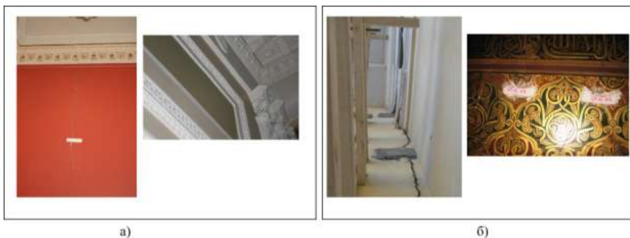
Рисунок 4.19 – Формирование трещин в несущих конструкциях Юсуповского дворца: а) Античный зал, б) Мавританская гостиная
