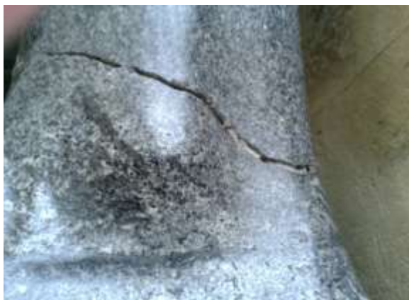
Рисунок 3.31 – Трещины в несущих конструкциях – ступня Атланта (фото автора, 2014 г.)
