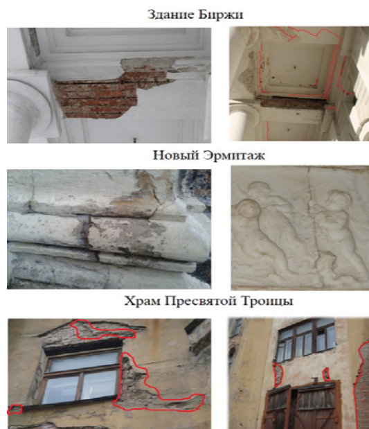
Рисунок 6 – Развитие трещин в несущих конструкциях рассматриваемых архитектурно-исторических памятников
