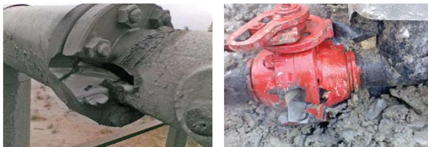
Рисунок 1.2 – Разрушение обвязки скважины в результате абразивного износа
