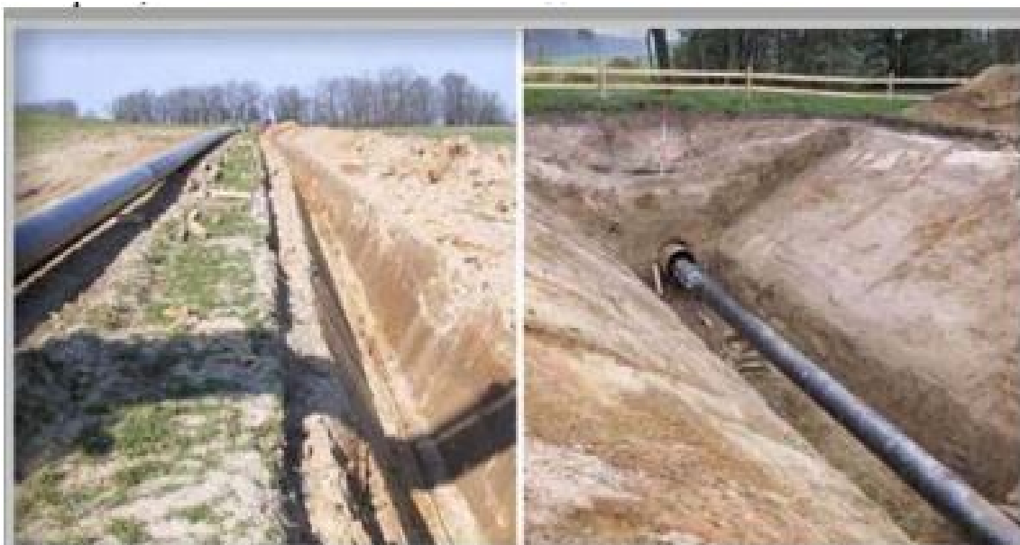
Рисунок 2.6 - Оптоволоконный кабель, проложенный вдоль трубопровода
