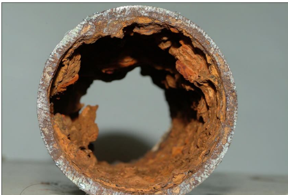
Рисунок 1.2 – Коррозия металла на нефтепроводе
